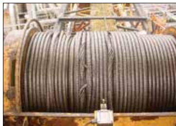
Figura 2 - Danos no cabo de aço
